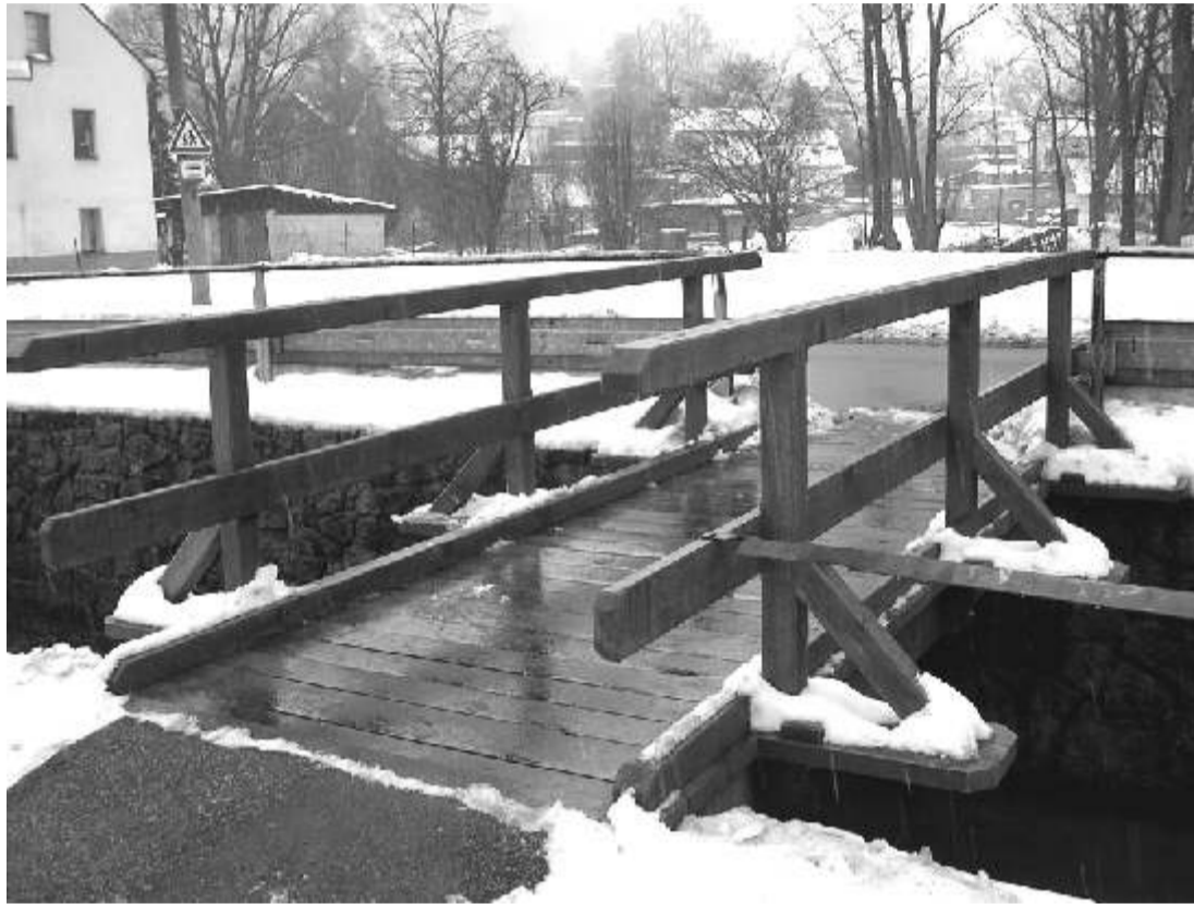
Místní firma Daniel Štika provedla kompletní rekonstrukci dřevěné lávky přes Luční potok, která byla v havarijním stavu. Foto: Vilém Madunický
